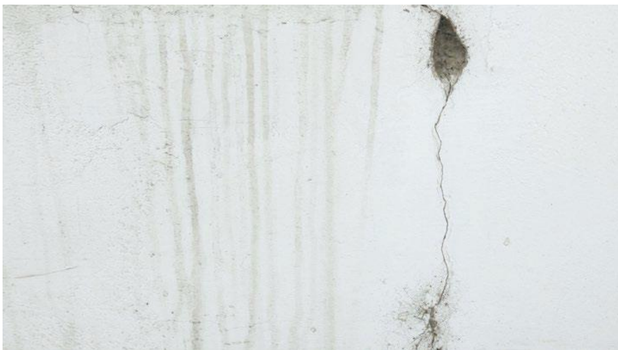
Zdjęcie nr 3 - Pęknięcia na elewacji
