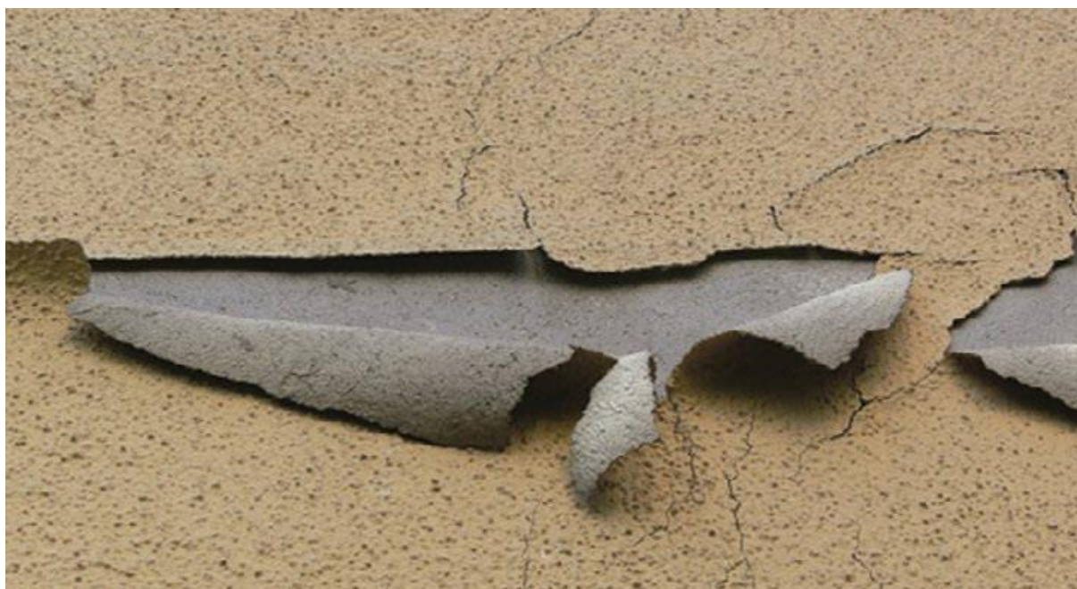
Zdjęcie nr 4 - Odspojenie tynku
