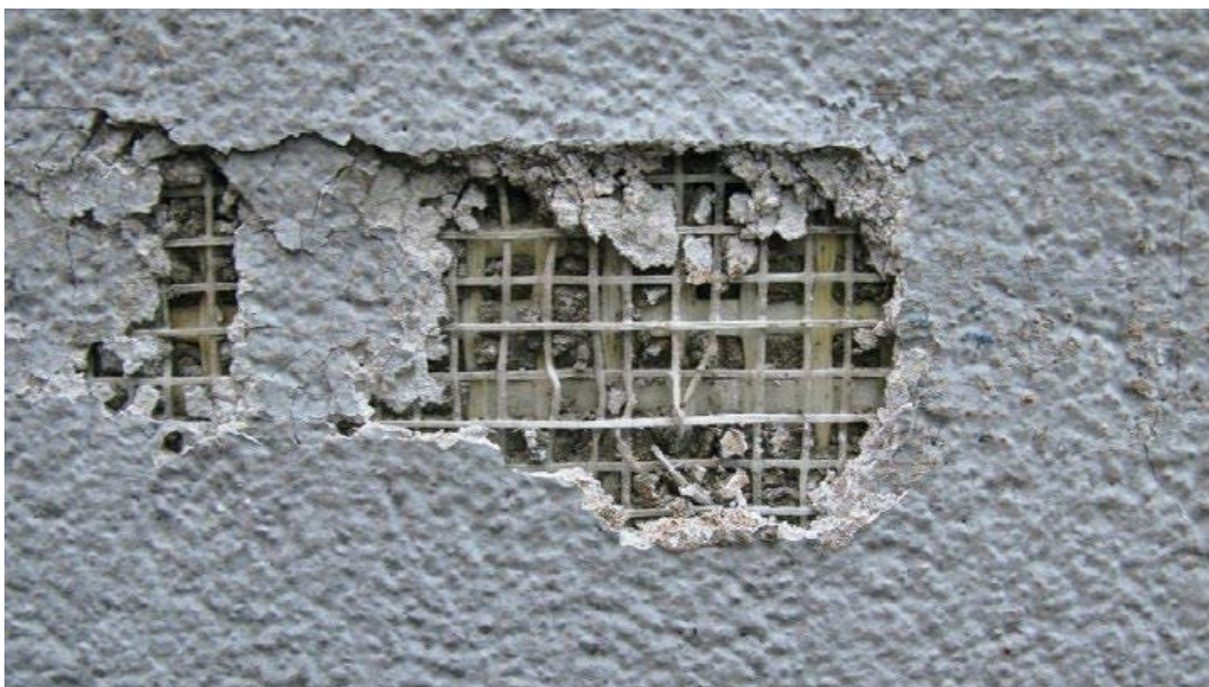
Zdjęcie nr 5 - Uszkodzona powłoka zewnętrzna elewacji
